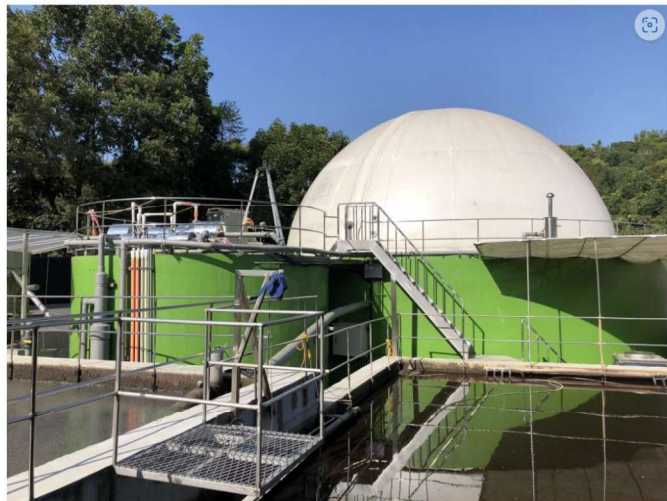
新合興牧場的兩階段厭氧槽分別建置前厭氧醱槽（氫氣）、主厭氧醱槽（甲烷），兩者相加的氫甲烷總能源回收效率更佳，再加上客製化設計的攪拌構造，可定時、定速、全方位攪拌，智能化管理。
