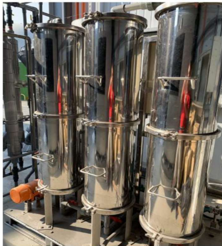
脫硫設備，將沼氣中具有腐蝕性的硫化氫去除。
